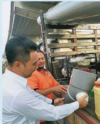
阿茲米占 (右) 查看直徑8吋的較大排水管，盼能加建公路橋的排水功率。
